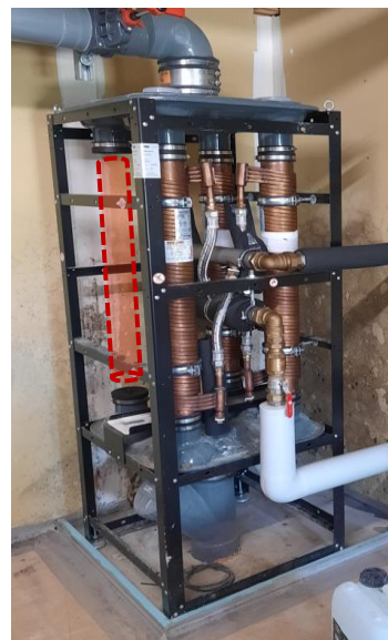
Récupérateur de chaleur sur eau grise R+8_Sud
