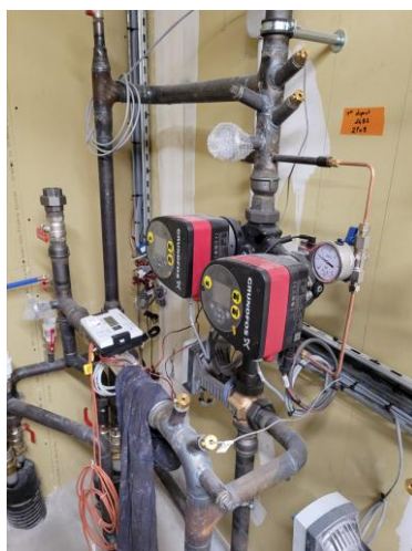
Double pompe chauffage et pompe de charge ECS
